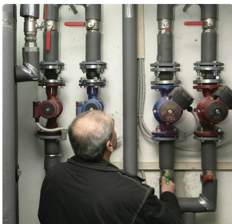
Rohrsystem in einer Apartmentwohnanlage
