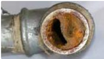
Tubería con depósitos calcáreos
