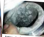
Antes de la instalación de Vulcan: la tubería estaba llena de incrustaciones.
