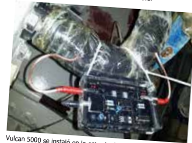
Vulcan 5000 se instaló en la entrada de agua del cuarto de reciclaje de agua.
