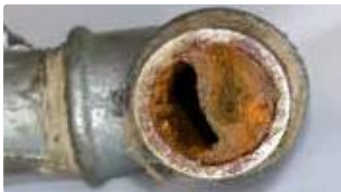
Stark verkalktes Rohr
