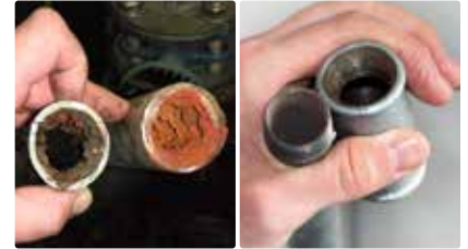
Rohrleitungen aus einem Maschinenraum
