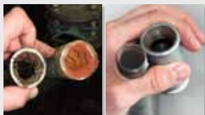
Sistema de tuberías
