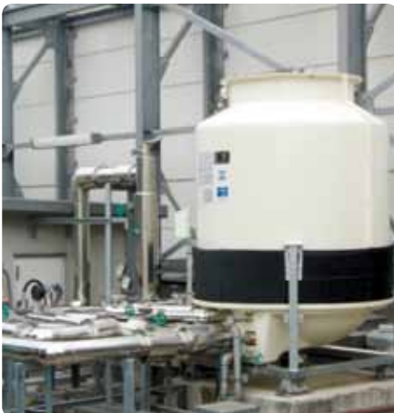
Torre de refrigeración
