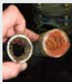
Sistema de tuberías
