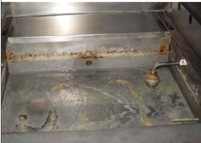
Antes de instalar Vulcan: en la bandeja se aprecia el calcio endurecido y las tuberías socavadas.
