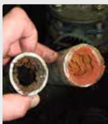
Sistema de tuberías
