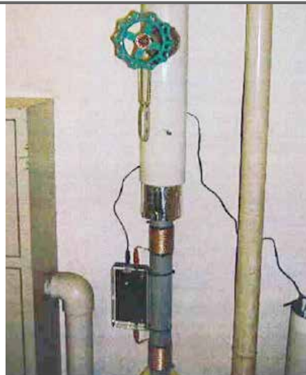
Vulcan 5000 instalado en la cocina de la fábrica.
