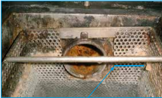
Nivel normal de agua estancada.
